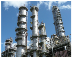
スチレンモノマー製造設備
