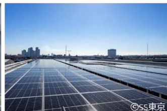
©SS東京 太陽光発電設備
