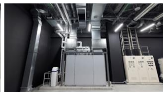
実機研修室（空調衛生）
