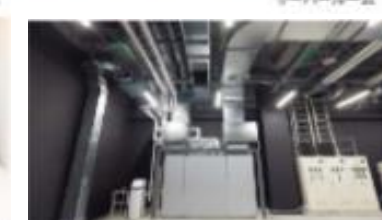
実機研修室（空調衛生）
