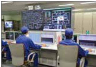
汚泥処理施設運転監視
