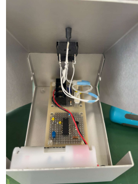
LED 点灯ボックス内部
