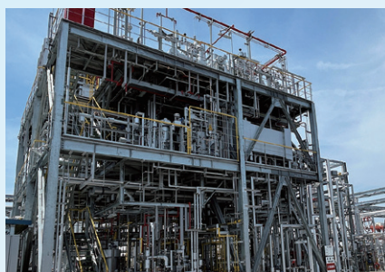
エタノールからプロピレンを直接製造するパイロット設備 ※この設備は、NEDO(国立研究開発法人新エネルギー・産業技術 総合開発機構)のグリーンイノベーション基金の支援を受けています。
