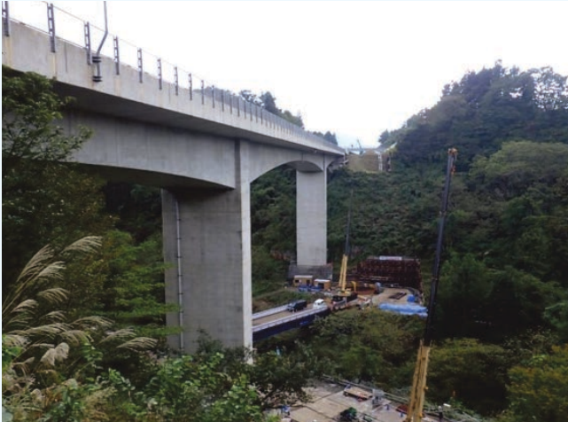
●上信越自動車道 渋江川橋 (P C 上部工) の施工管理<NEXCO>
