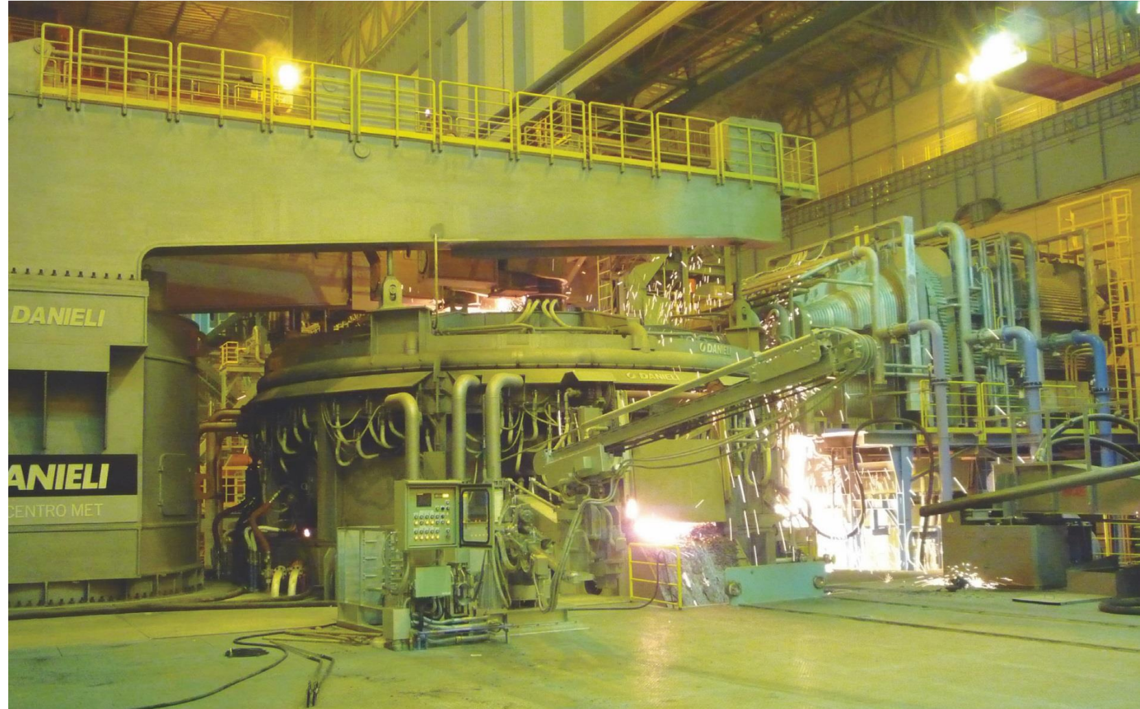
世界最大級の420トン電気炉(田原工場)
