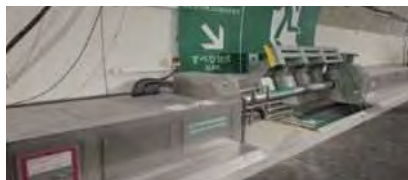
トンネル設備
