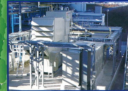
コ・ジェネレーションシステム
