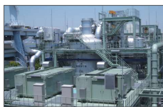
省エネルギー型焼却炉
