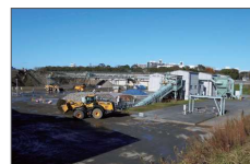
中川建設発生土改良プラント全景
